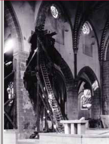
Einer der Vierungspfeiler wurde schwer getroffen. Man mag sich nicht ausmalen, welche großen Schäden es gegeben hätte, wäre er vollständig zusammengebrochen
